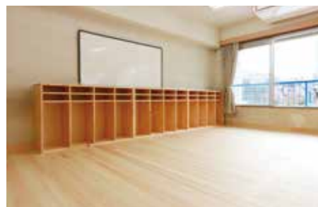
大阪市東住吉区 平和幼稚園様 2階教室改修工事/床・ロッカー・収納BOX
