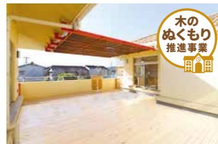
大阪市住之江区 安立保育園様 屋外テラス工事・防水工事/ ウッドデッキ
